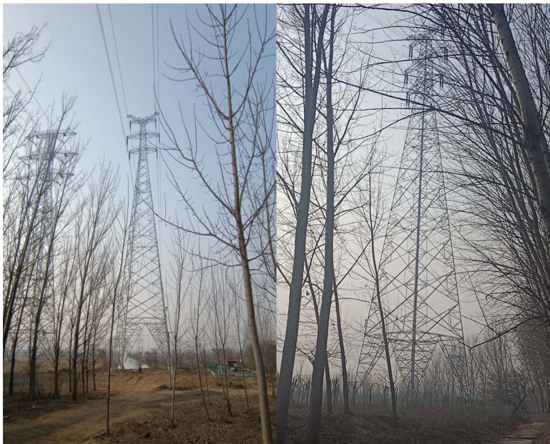
北运河东黄线区 1 基塔
