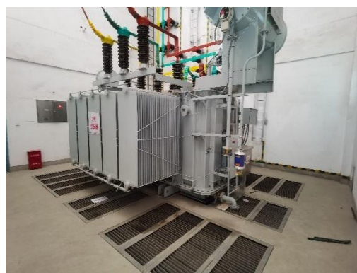
3#主变、事故油坑
