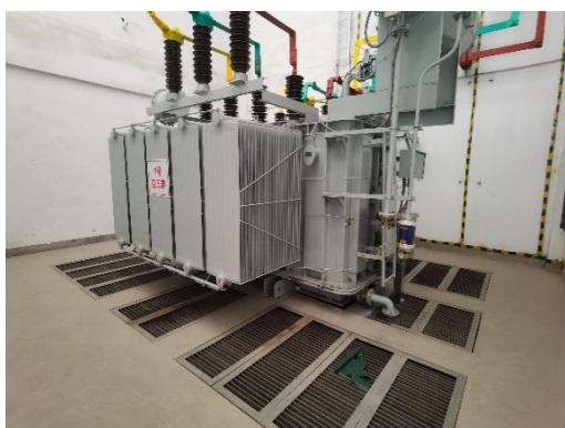
1#主变、事故油坑
