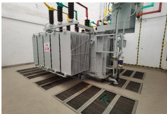
1#主变事故油坑
