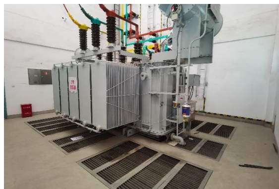
3#主变事故油坑
