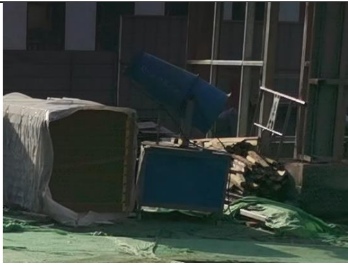
施工期除尘雾炮机
