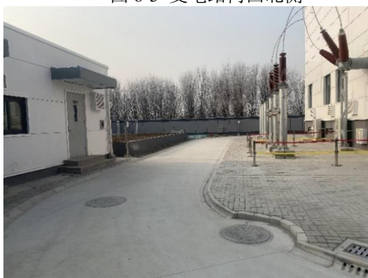
图 8-5 变电站内西南侧
