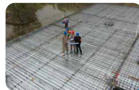
桥北110千伏输变电工程的全面投产 ▲
