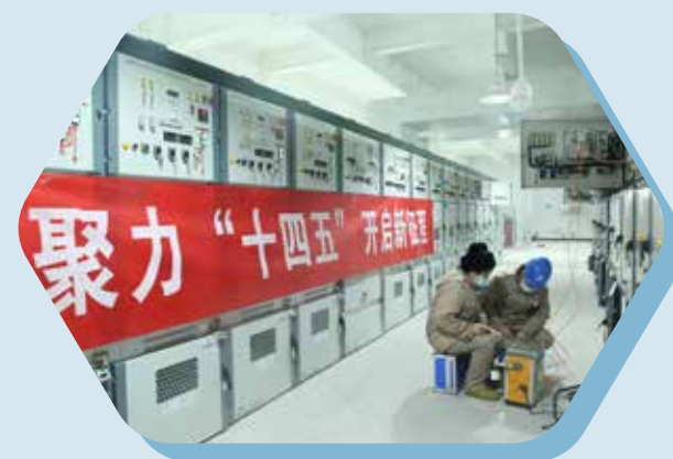
在110千伏海清路变电站进行验收处缺工作 全力保障送电“零隐患”
