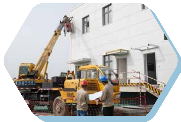
桥北110千伏变电站为吾悦广场提供用电保障
