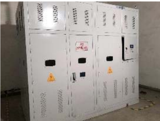
3#主变压器 35kV 小电阻
