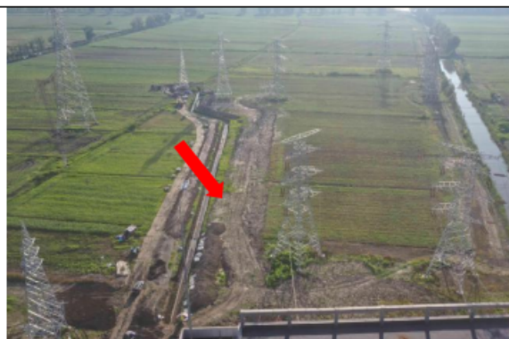
张岗铺变电站西侧电缆出线
