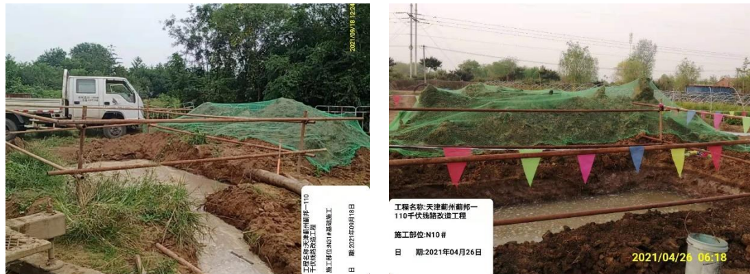
图 8-3 施工期泥浆废水处理设施
