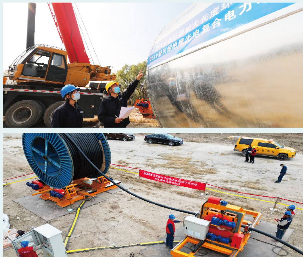
国内首条公里级聚丙烯绿色环保电缆在津投运
