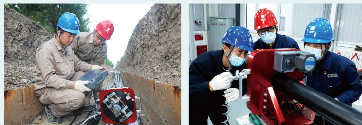
《高压电缆接头自动化预处理装置关键技术研发与应用》 获国网天津市电力公司科技进步一等奖
