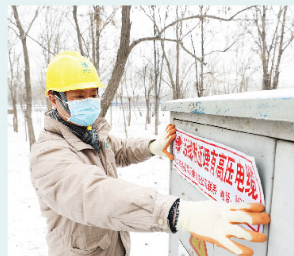
治理通道警示牌歪斜、缺失隐患 7410块
