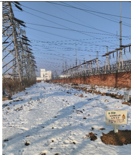
电缆线路警告标识及附近架空线路
