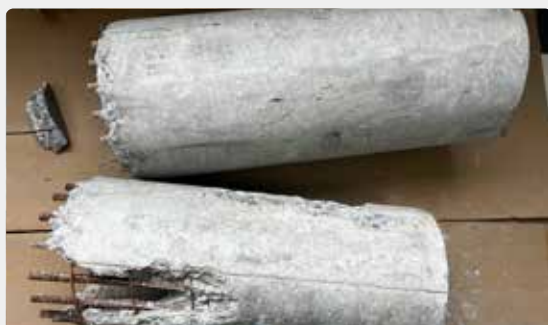
水泥电杆钢筋锈蚀
