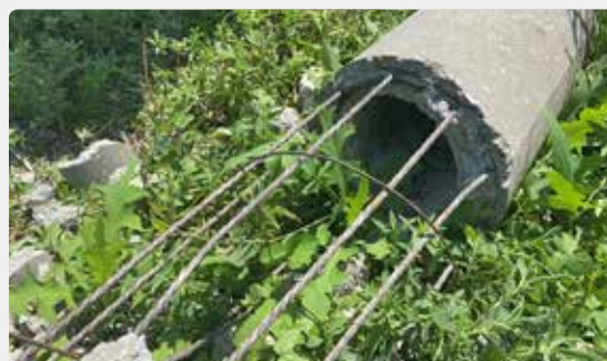
水泥电杆纵筋分布不均匀
