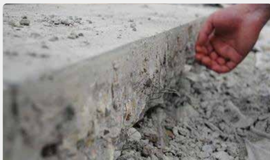
钢纤维外漏锈蚀
