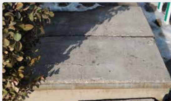
钢纤维混凝土盖板劣化
