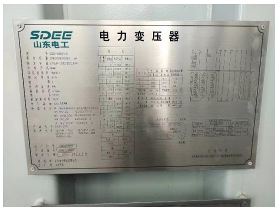
1#主变压器铭牌
