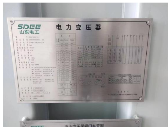
2#主变压器铭牌
