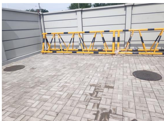
变电站内西南侧
