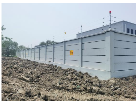
变电站外东侧
